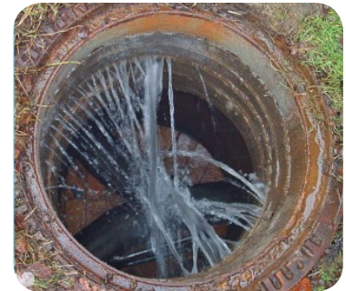
Grundwassereintritt im undichten Kanalschacht.
